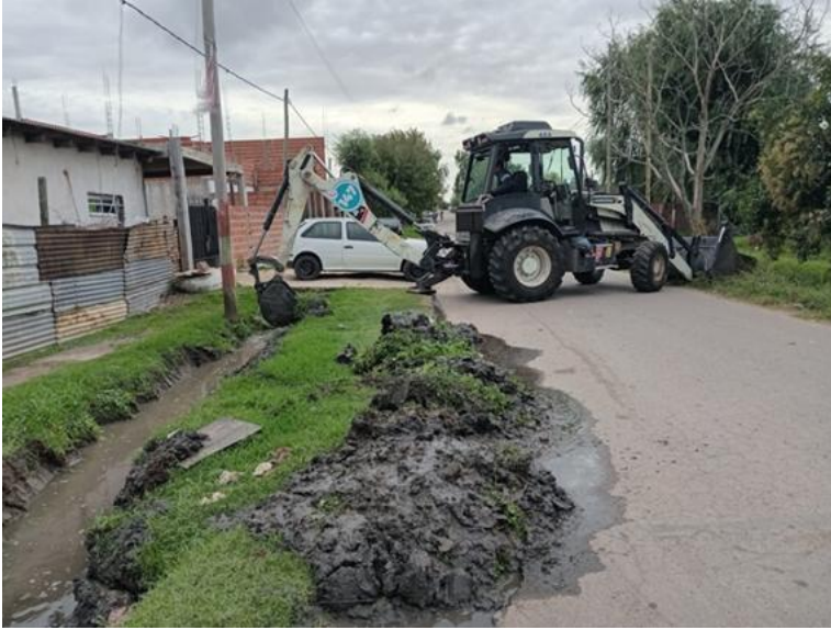
FOTOGRAFÍA 17. Limpieza mecánica de zanjas en Puente de Fierro a cargo de la Delegación Municipal por solicitud de la ACP y MTP
